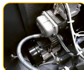
Circuito aire-aceite Todos los latiguillos del circuito aire-aceite están realizados en goma recubierta de malla metálica resistente a las altas temperaturas
